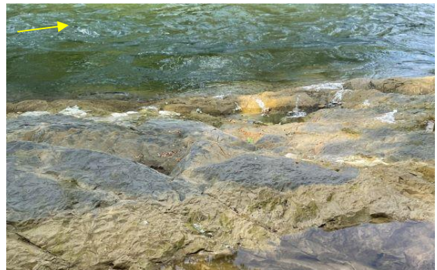
図-1 風化によって変色した岩盤の表面（釧路川 KP70.5）
